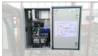
Шкаф ПТК ССПИ ЭНТЕК
